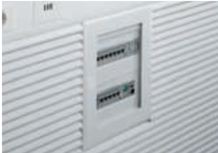
Skrzynka rozdzielcza z przezroczystymi drzwiami
